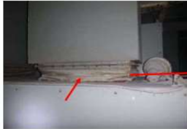
ダクトフランジ 約50メートル(mに1箇所) 約100箇所
